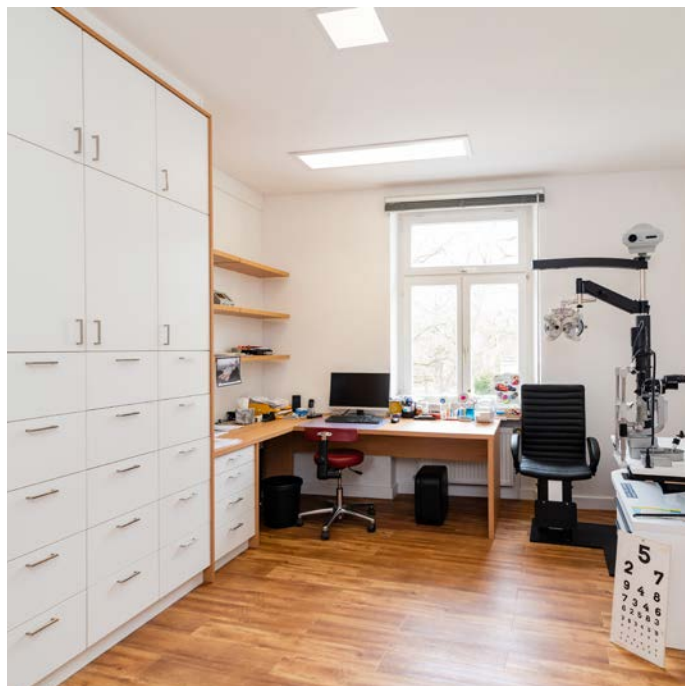
Abb.: Die Behandlungszimmer wurden mit zwei Schaltkreisen versehen. So lässt sich die Schreibtischbeleuchtung getrennt von der Grundbeleuchtung schalten und dimmen.
